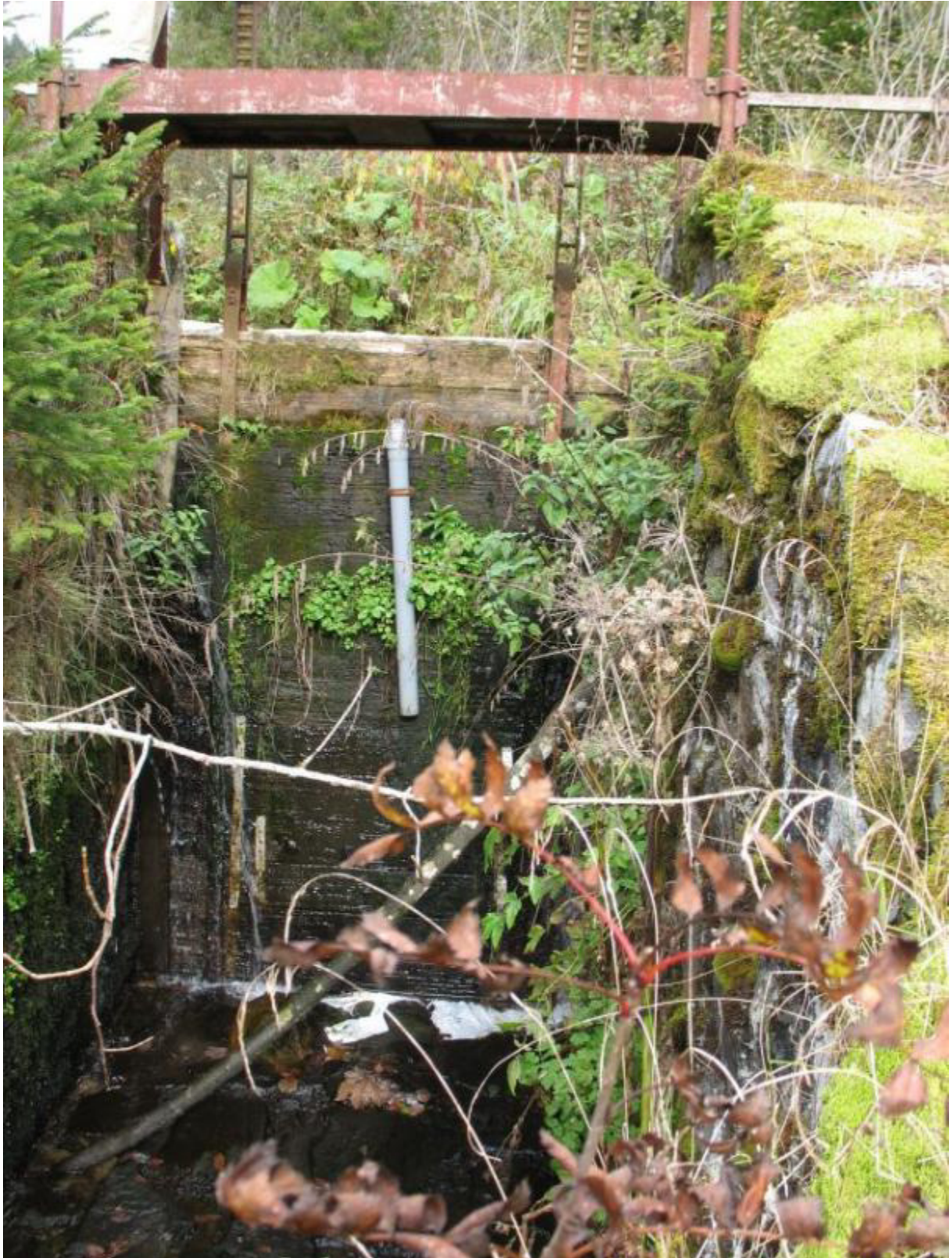
An der Wasserkraftanlage Glashütte im Südschwarzwald hat ein Umweltgutachter bescheinigt, dass der Einbau eines Plastikrohres im Schütz zum Zwecke der Mindestwasserdotierung in der Ausleitungsstrecke eine „wesentliche ökologische Verbesserung“ sei – Ansicht von Unterwasser. (Foto: Nikolaus Geiler)
