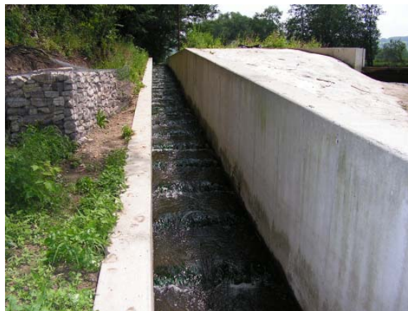
(3) Borstenfischpass an der Wasserkraftanlage Camburg/Döbritschen (Thüringen)
